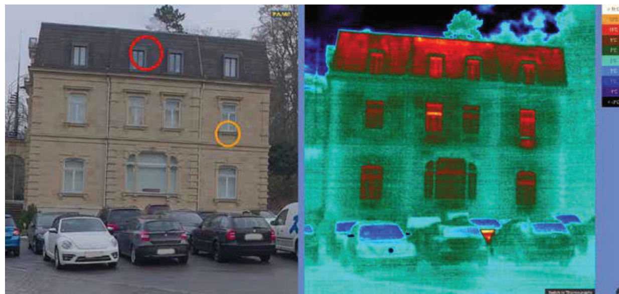
Abbildung 2: Links ist ein Ausschnitt des 100 Megapixel Fotopanoramas und rechts der dazu passende Ausschnitt aus dem 25 Megapixel Thermografiepanorama. Man erkennt die thermischen Schwachstellen am Dach und an den Fenstern, die Fassade ist in Ordnung.
